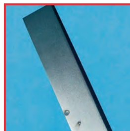
Voorbeeld voor putcorrosie
