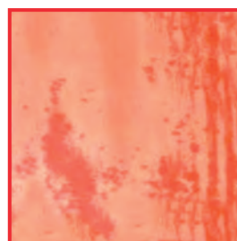
Materiaalaantasting van de natuurlijk/gekleurd geanodiseerde aluminium oppervlakken bij containers. Oorzaken: ontoelaatbaar hoge alkalische wasoplossing
