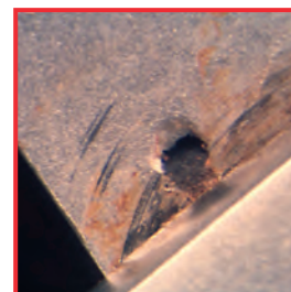
Voorbeeld voor putcorrosie
